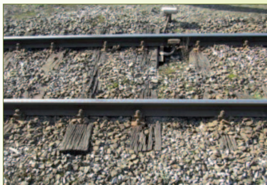
Impressie van de rotte toestand van de dwarsliggers net naast de Scheldebrug, kant Temse
